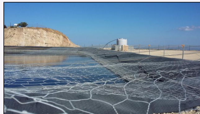
Κάλυψη δεξαμενών με πλέγμα
