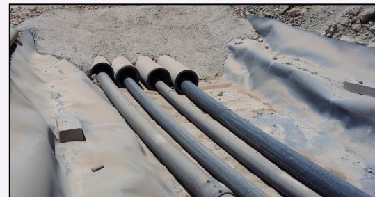
Σωλήνες διακίνησης κυανιούχων διαλυμάτων
