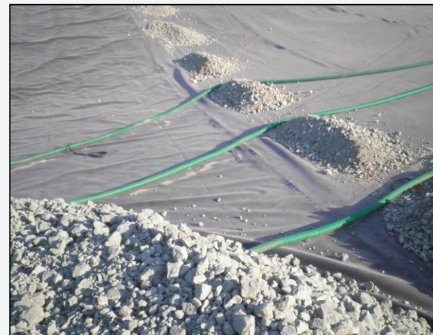
Σωλήνες αποστράγγισης (drain coils) στη βάση των σωρών εκχύλισης
